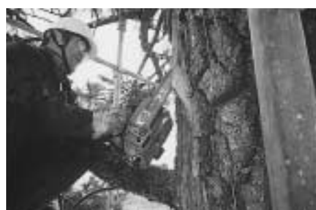
チェーンソーにて腐朽部の除去。この後、殺菌剤を塗り、水が入らないようにウレタンを詰め、表面を固めてペイントで仕上げます。
