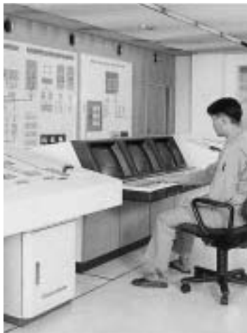
中央管理室(三野浄水場)
