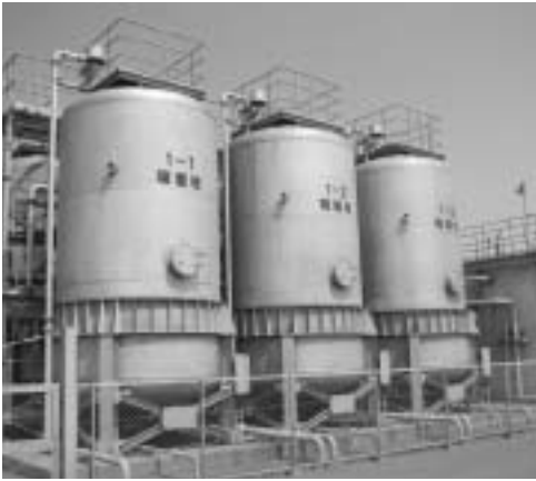
排水処理施設。24時間体制で連続監視し、もし異常があった場合は排水がストップするようになっています。
