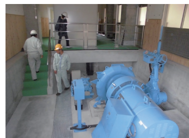
今年7月に大規模リプレース工事が竣工し、再稼働した西粟倉水力発電所「めぐみ」の内部にある発電機と水車。
