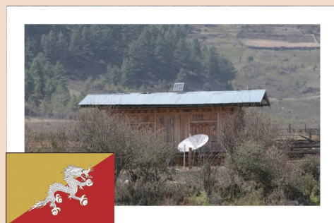
※屋根の上に60cm×60cm程度の大きさのソーラーパネルが設置されています
