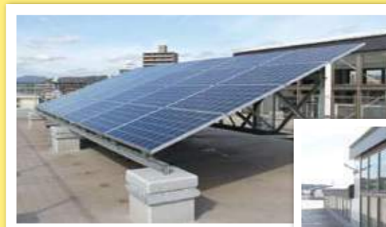
屋上に設置された太陽光パネル
