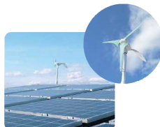
事業所内の太陽光発電、風力発電
